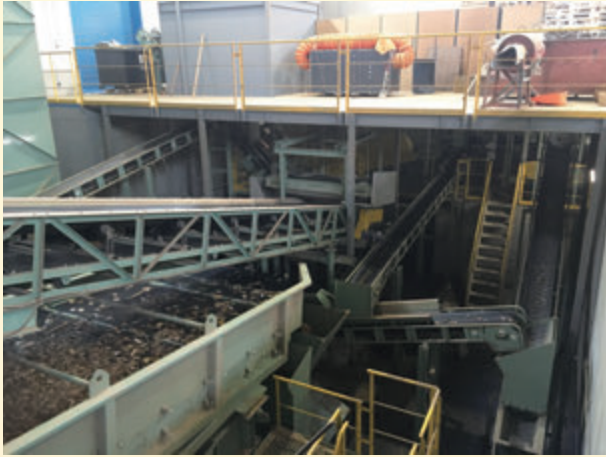
破碎機のベルトコンベアー
