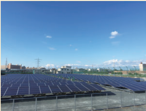
貯木場跡地に広がる太陽光発電設備
