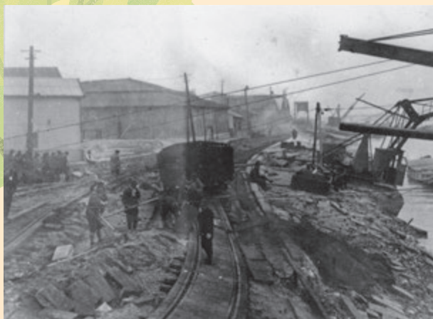
東南海地震により倒壊した2号地(現、ガーデンふ頭)東側護岸(写真提供：名古屋港管理組合)
