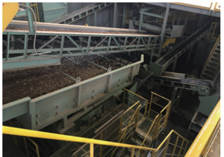
破砕機のベルトコンベアー
