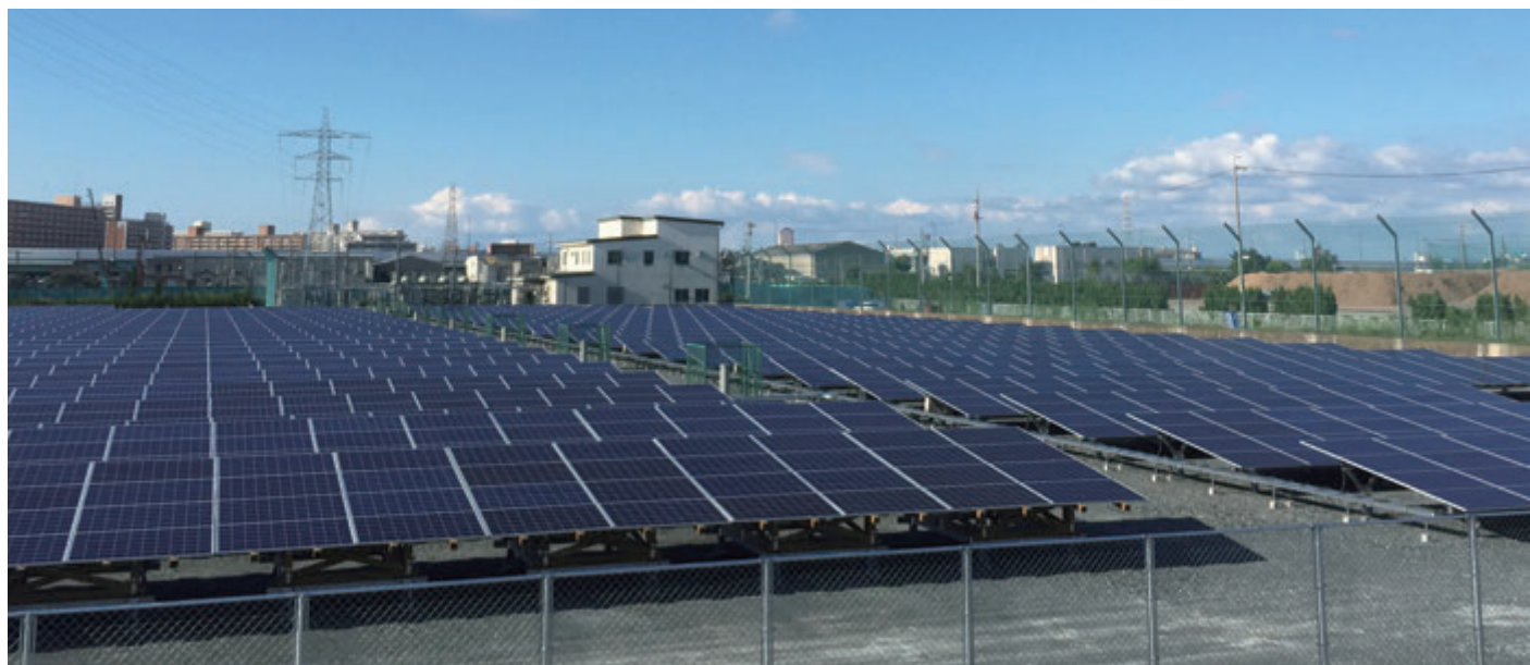
太陽光発電設備
