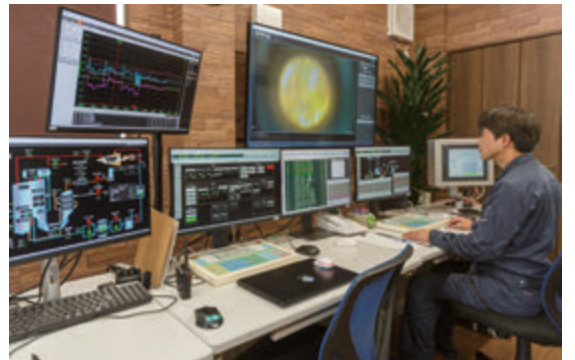
システムモニター室
